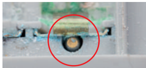
Zanieczyszczone przez wyciek główne złącze baterii.
